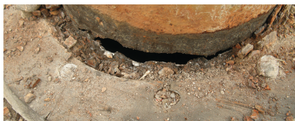
Vagabonderande strömmar framkallar rost
